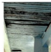
Forros e lajes - PÉSSIMO
