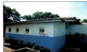
Janelas (esquadrias e vidros) - PÉSSIMO
